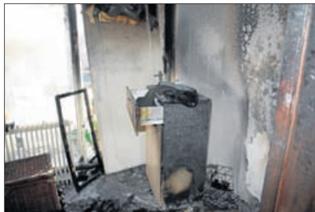
De ravage na de brand in de flatwoning.
