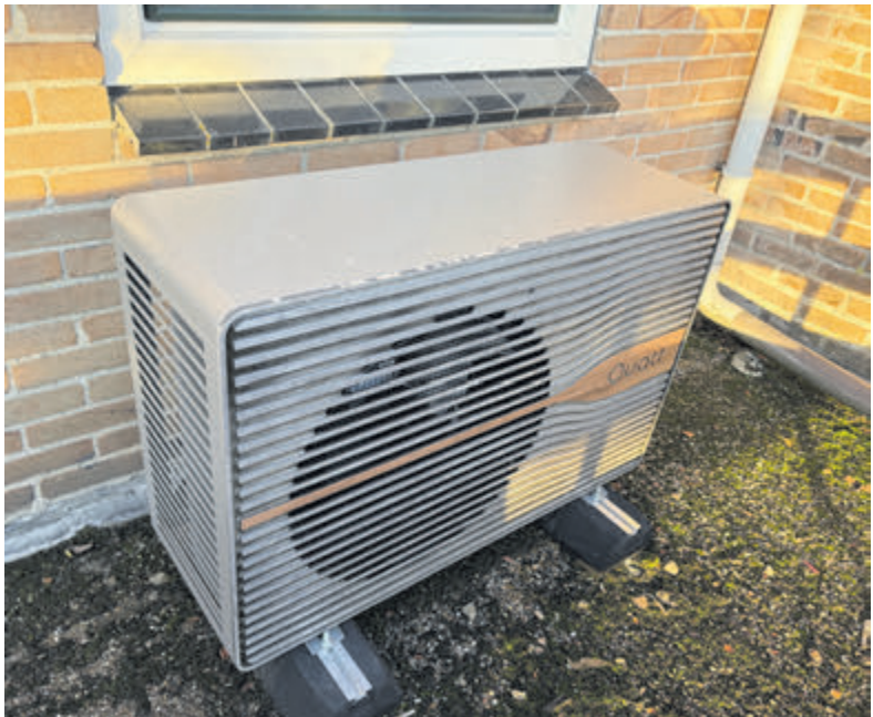
Buitenunit van een hybride warmtepomp. Foto: Ans Pelzer
